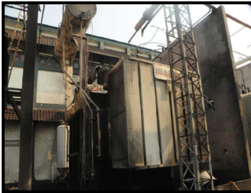
Gambar 4.8.: Foto setelah terjadi kebakaran
